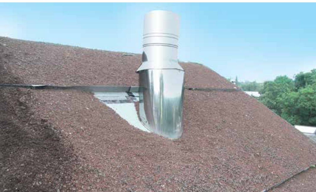
Abb. 3: Aufgehende Bauteile sind auch windgefährdet
