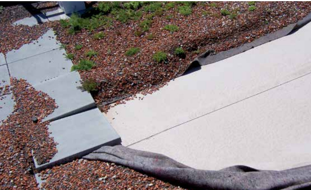
Abb. 2: Verwehungen, die in diesem Fall bis auf die Dachabdichtung gehen
