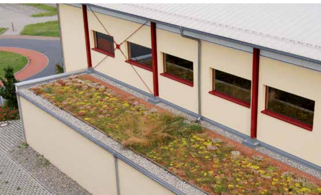
Foto 3 Wasseransammlung Das zusätzlich anfallende Wasser der Metalldächer ist zu berücksichtigen
