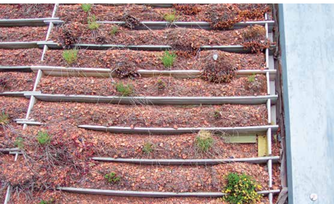
Foto 3 Falsches Substrat bei dieser Steildachbe- grünung: zu grobkörnig mit zu geringem organischen Anteil
