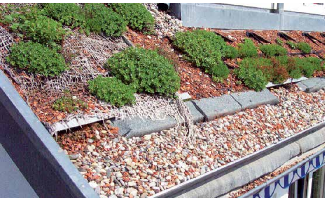
Foto 3 Substratauswaschungen Substratauswaschung bei Steildächern aufgrund der fehlenden Vegetation
