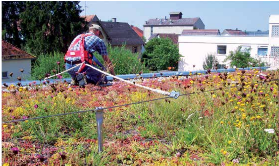
Absturzsicherung ist in der Bau- und Nutzungsphase vorzusehen – hier Optisafe Typ Liner
