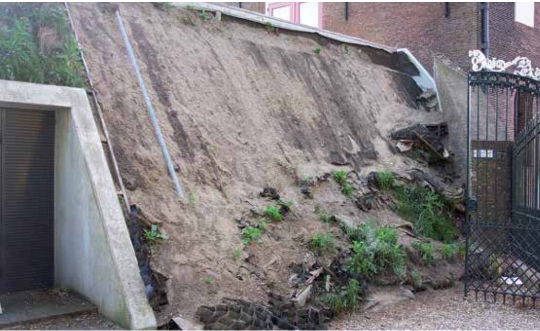
Abb. 1: Abgerutschtes Dach Ursache waren ungeeignete Schub-sicherungen und nicht angewachsene Vegetationsmatten.
