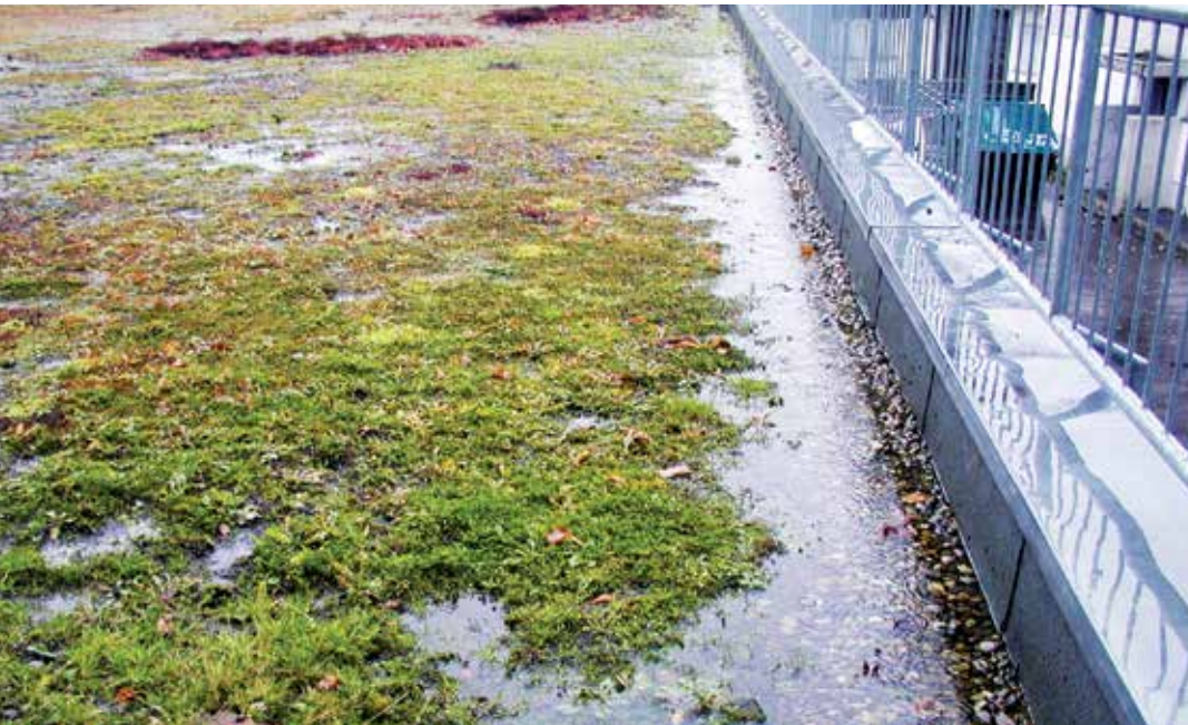
Foto 1 Wasseranstau Laub am Dachablauf kann die Ursache für ungeplanten Wasseranstau sein
