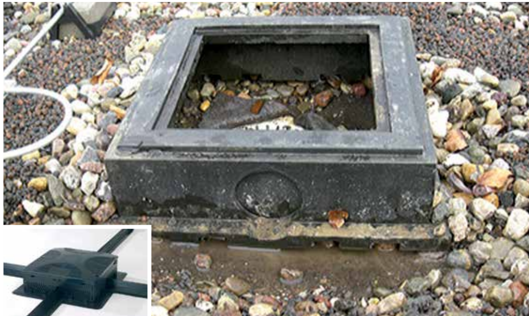
Abb. 4 Wasseranstau Grund dafür ist ein Kontrollschacht ohne Wasserleitprofile und mit viel zu geringen Öffnungsweiten. Korrekt: mit Optigrün-Kombi-Kontrollschacht und Wasserleitprofilen (kleine Abb).
