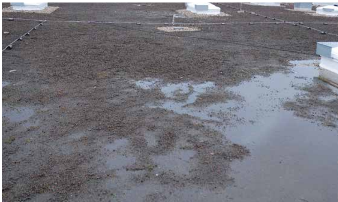
Abb. 5 Stehendes Wasser bis ins Substrat Drainage falsch bemessen.
