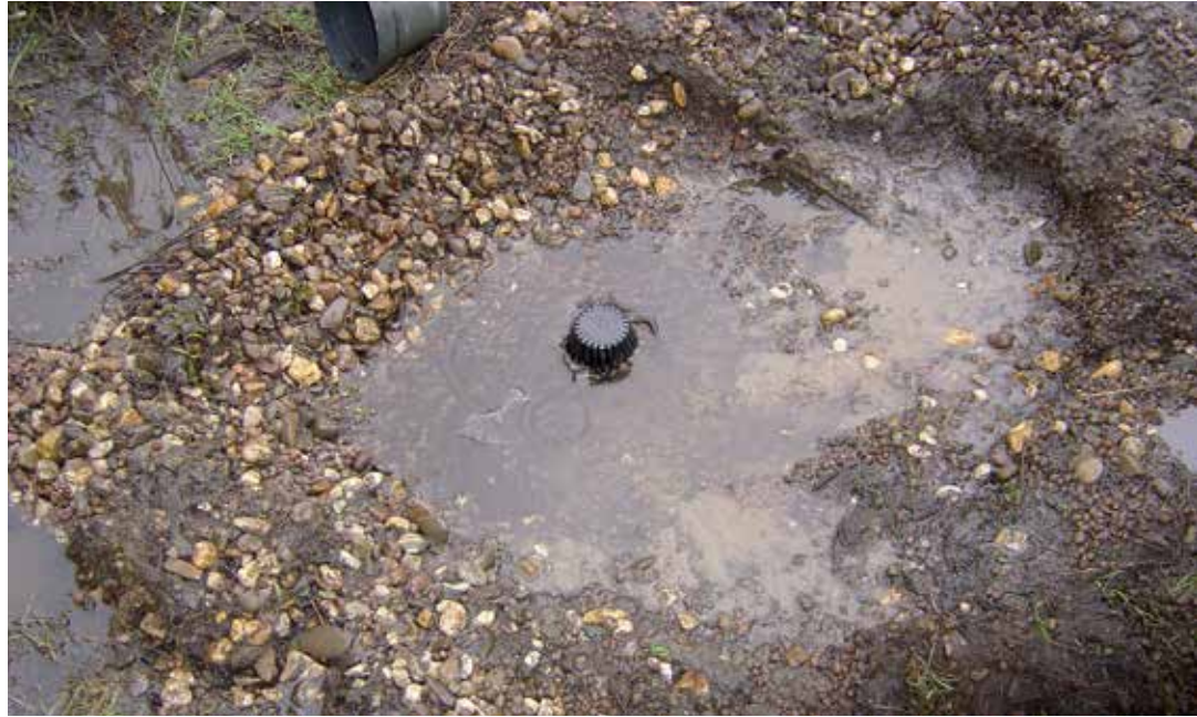
Abb. 3 Stehendes Wasser um einen Dachablauf. Ursache ist ein hochgezogenes, undurchlässiges Schutzvlies.
